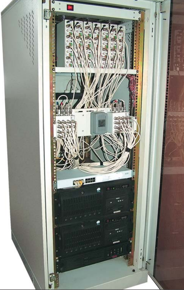
Рис. 3. Стойка с оборудованием.
